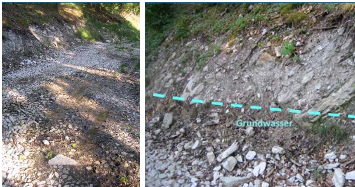
Abb. 3: Beispiel einer Freilegung von Grundwasser durch Forstwegeneubau mit nachfolgender Verkeimung einer Quelltrinkwasserversorgung (Fränkische Alb, Foto: LfU).
