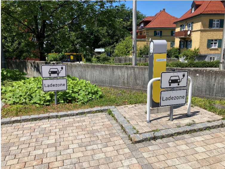
Eichrechtskonforme Ladesäule am Landratsamt Mühldorf a. Inn
